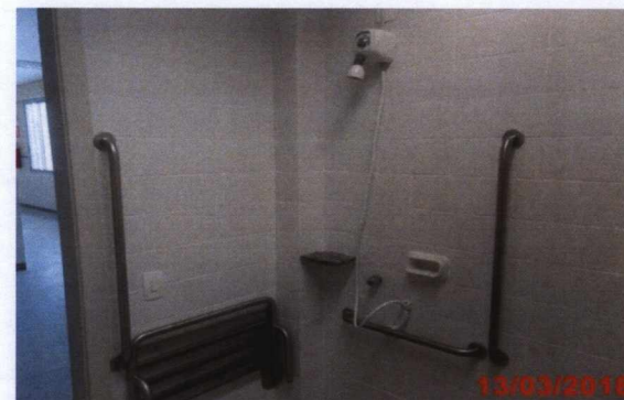
Creab – Vestiário feminino acessível.
