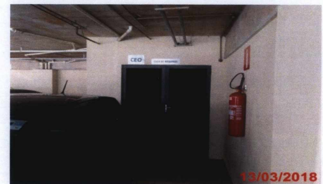
Subsolo – Casa de máquinas odontologia.
