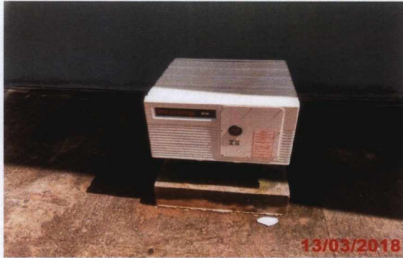
Trocador de calor da piscina.
