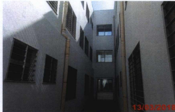
Fosso de Ventilação Bloco 01.
