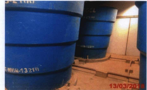
Rede de água fria e caixa d'água.
