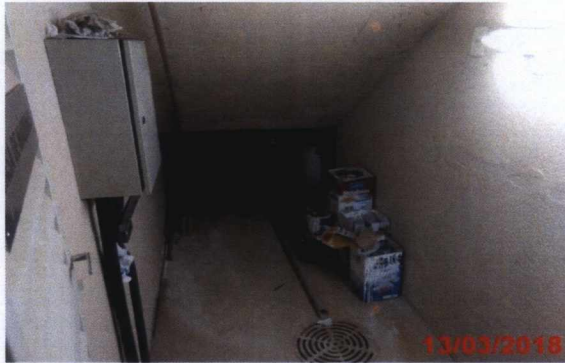
Casa de máquinas embaixo da escada no subsolo.
