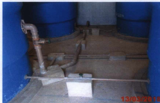
Rede de água fria e caixa d'água.
