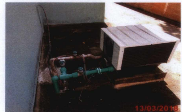
Trocador de calor da piscina.
