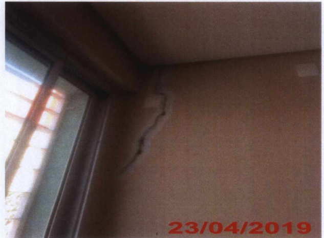
Tratamento de trinca na parede da sala de espera – Centro de Saúde 1º Pavimento.
