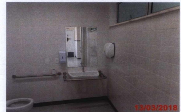
Creab – Vestiário feminino acessível.
