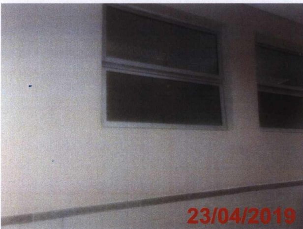
Pintura pós-tratamento de trinca na parede da área de circulação – Centro de Saúde 1º Pavimento.
