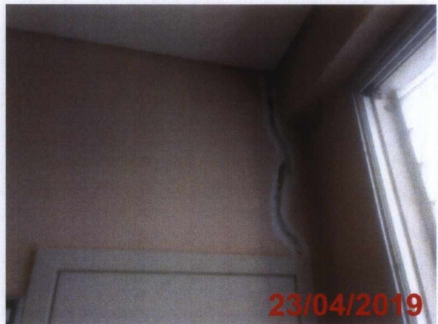
Tratamento de trinca na parede do Consultório 02 – Centro de Saúde 1º Pavimento.
