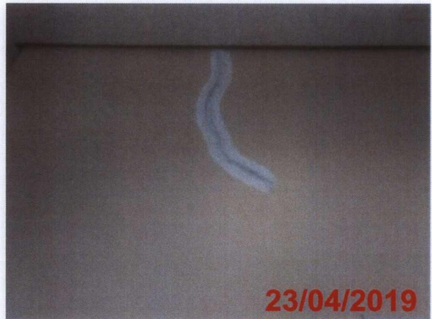
Tratamento de trinca na parede da sala de Farmácia – Centro de Saúde 1º Pavimento.
