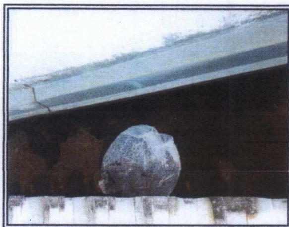
Foto: 08-04-19 – Falta de limpeza das grelhas e calhas
