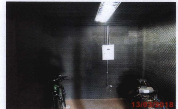
Subsolo – Casa de máquinas odontologia.
