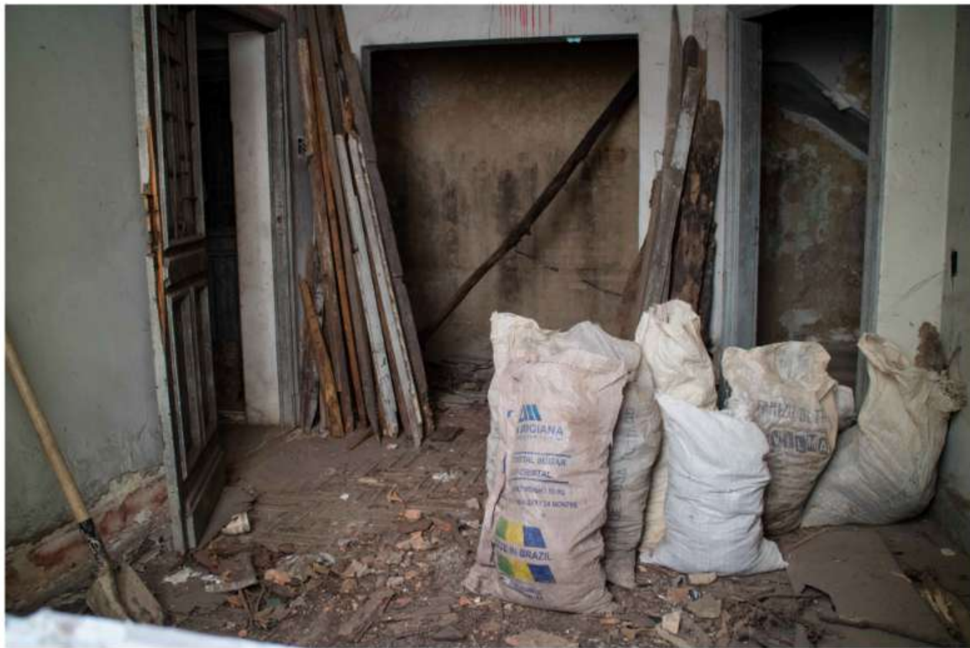
Entulho do forro no primeiro pavimento da Casa 2
