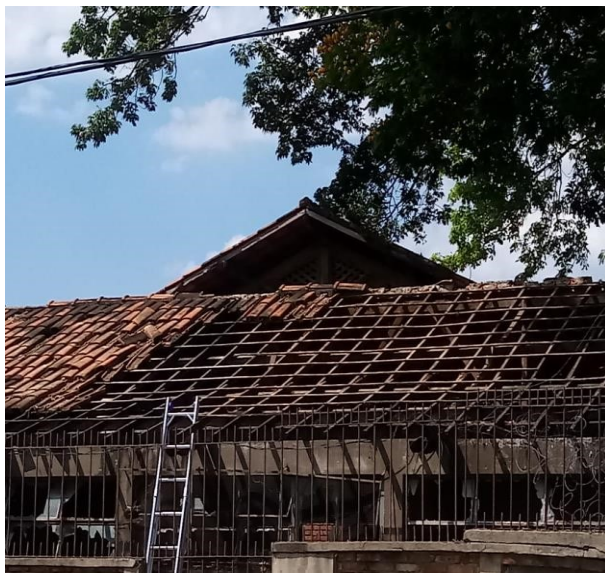
Foto 3 - HOSPITAL PÚBLICO VETERINÁRIO TELHADO FACHADA RUA PEDRO BIZZOTO- ANTES
