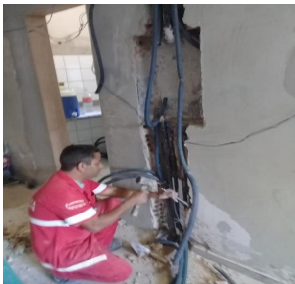
Foto 19 - HOSPITAL PÚBLICO VETERINÁRIO QUADRO DE DISTRIBUIÇÃO DE CIRCUITOS NO SUBSOLO- ANTES
