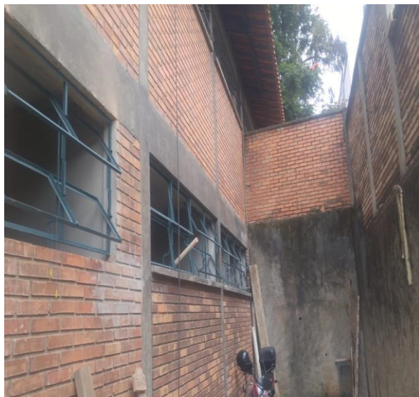
Foto 23 - HOSPITAL PÚBLICO VETERINÁRIO ÁREA DO SOLÁRIO- ANTES
