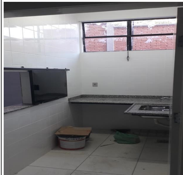
Foto 48 - HOSPITAL PUBLICO VETERINARIO PREPARO CIRÚRGICO
