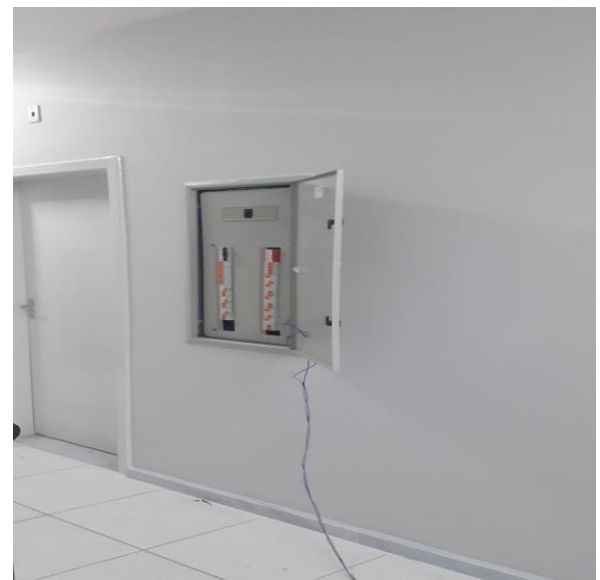
Foto 20 - HOSPITAL PÚBLICO VETERINÁRIO QUADRO DE DISTRIBUIÇÃO DE CIRCUITOS NO SUBSOLO- DEPOIS
