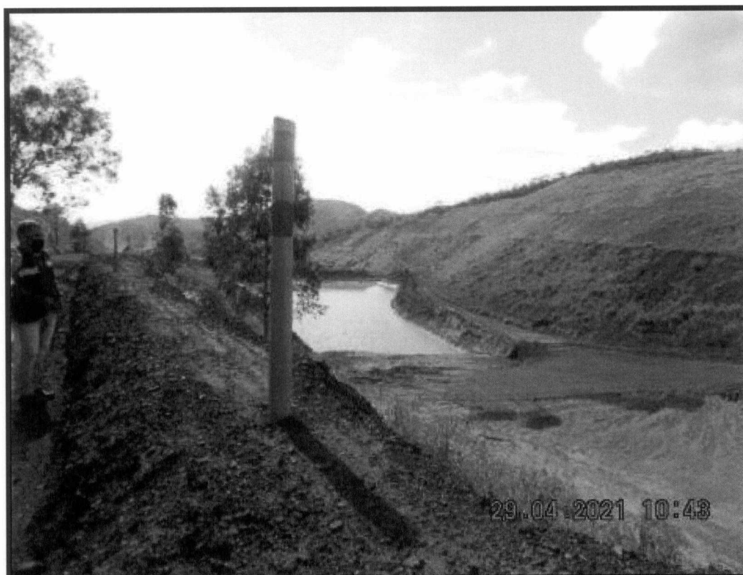
FOTO 16 - 3º SUMP COM ÁGUA DAS CHUVAS
