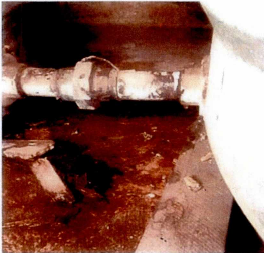
Figura 08 – Vazamento nas conexões da caixa d'água sobre a laje da sala de curativo. (Fonte: autor, 11-02- 2022).
