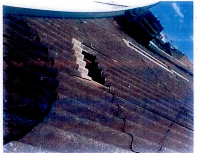
Figura 11 – Telha desloca por morador de rua e o motivo de infiltração no consultório odontológico. (Fonte: autor, 11-02-2022).
