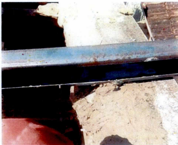
Figura 04 – Prolongamento dos perfis metálicos que servem de suporte e fixação das telhas. (Fonte: autor,24-02- 2022).
