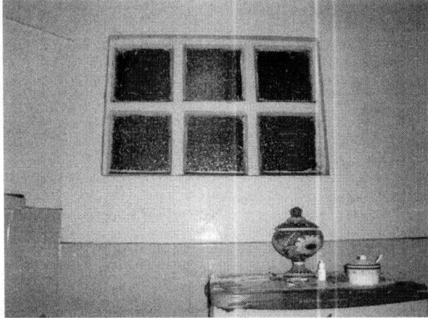
Vista interna da iluminação da cozinha voltada para o patamar da escada. Neste caso, o barrado original já foi substituído pelos azulejos.
