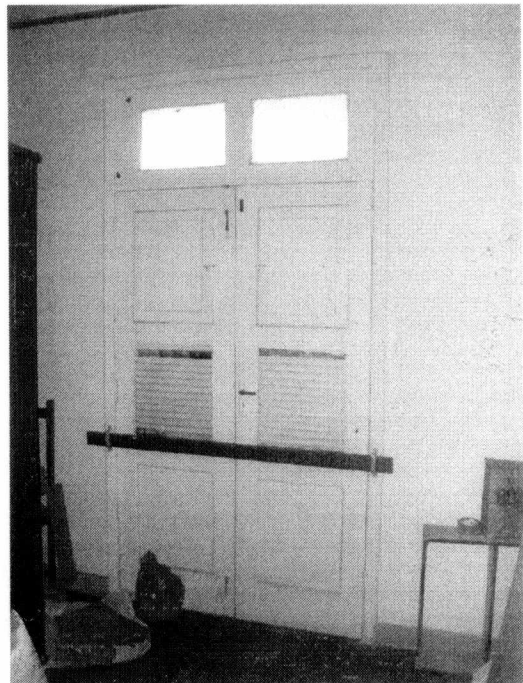
Neste detalhe, o mesmo padrão de porta, dupla, adaptado para a sala, vista interna. Rodapé original de marmorite.
