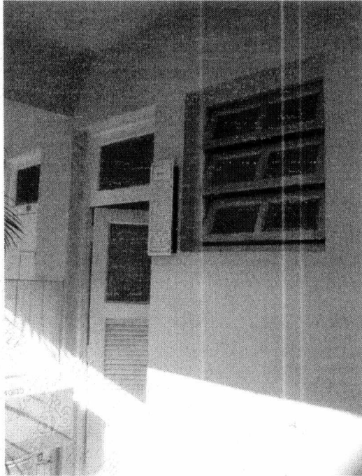
A porta de madeira, com veneziana, vidro e bandeira com vidro fixo.
