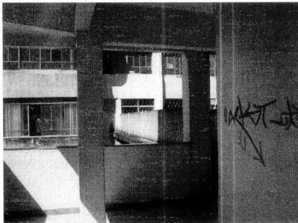
Ainda na seqüência, vista da passarela, tomada do Edifício 8. Note-se a elevação da parede acima do guarda-corpo da passarela.
