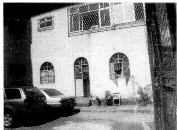
Aspecto de descaracterização no primeiro andar do Edifício 3.
