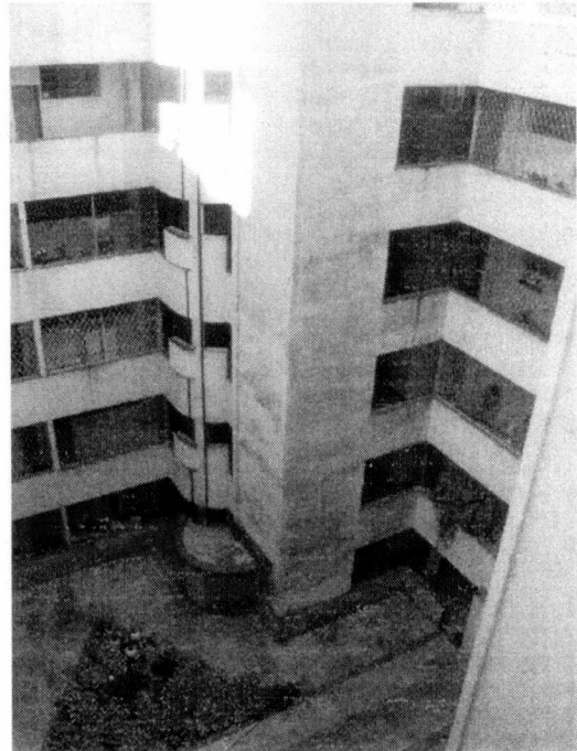
Vista de parte do pátio interno do Edifício 10, mostrando o coletor de lixo e a coluna destinada ao elevador.
